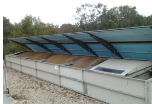
Station d'épuration à disques biologiques
