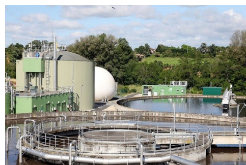
Digesteur, gazomètre, module d'épuration du biogaz et poste d'injection de biométhane de la station d'épuration d'Albi Madeleine Crédit photo : Communauté d'agglomération de l'Albigeois, www.grand-albigeois.fr
