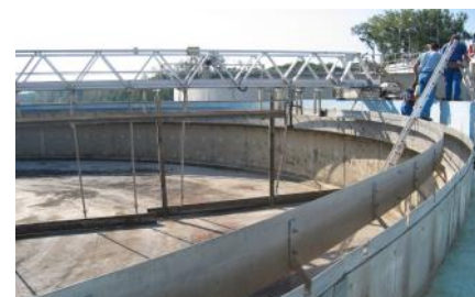
Clarificateur d'une STEU à boues activées
