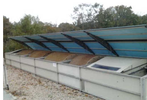
Station d'épuration à disques biologiques
