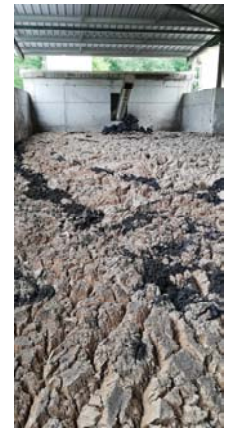
Stockage de boues chaulées
