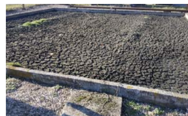
Lit de séchage de boues
