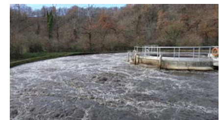
Bassin d'aération d'une STEU à boues activées
