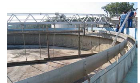
Clarificateur d'une STEU à boues activées
